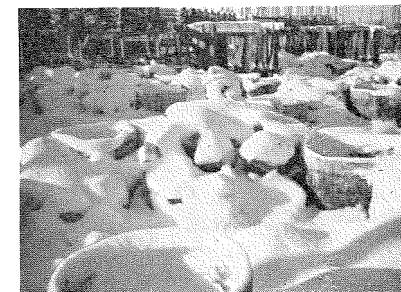
Fig. 1. En byggeplads den 28. november. Under uheldige omstændigheder kommer den ikke igang igen før hen på foråret.
